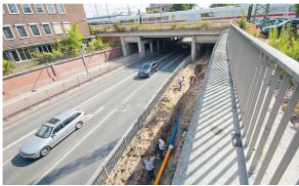
In dieser Woche wurden für den Umbau erste Kabel und Leitungen verlegt. Fotos: bec
